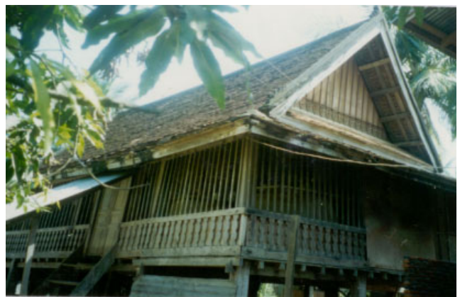
ປະເພດ Typologie ຊື່ບ້ານ Village ເລກທີ່ເຮືອນ No de maison ວັດສະດຸກໍ່ສ້າງ Materiaux de construction ນ້ຳເບີບັນຊີອະນຸລັກ No inventaire 66
